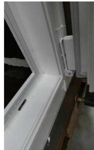
Foto.24 Sigillatura angolo inferiore destro telaio; visibile cerniera angolare e fessura di ingresso del drenaggio
