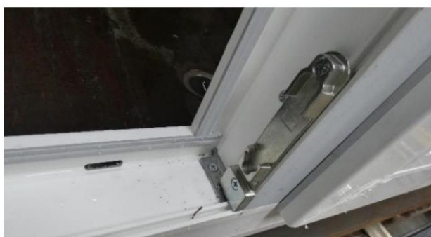
Foto.15 Sigillatura del corrispondente collegamento inferiore telaio e montante; riscontro verticale con inclinazione a vista, feritoia ingresso drenaggio
