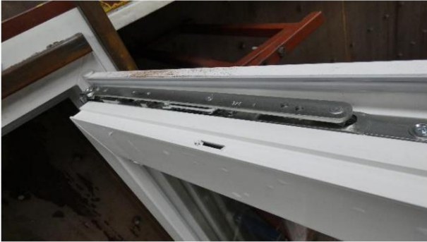
Foto.13 Barra superiore anta destra; ventilazione visibile fessura e supporto della cerniera
